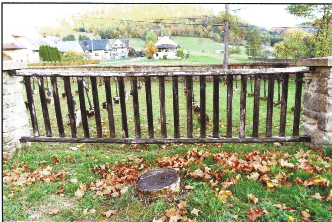
FOT. 23. CMENTARZ Z I WOJNY ŚWIATOWEJ NR 71 W ŁOSIU. Zniszczony odcinek drewnianego parkanu od str. zach., stan przed konserwacją. Październik 2022 r.
