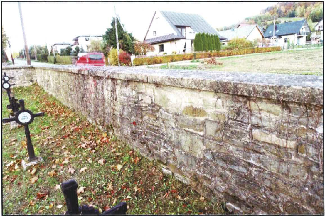
FOT. 10. CMENTARZ Z I WOJNY ŚWIATOWEJ NR 71 W ŁOSIU. Fragment muru kamiennego od str. płd.- zach, stan przed konserwacją. Październik 2022 r.
