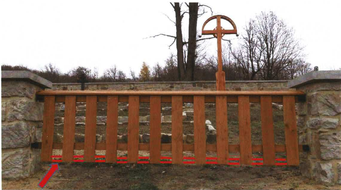
Parkan- cmentarz wojenny Nr 64 w Bartnym. Poprzeczna dolna belka parkanu powinna zostać obniżona do dolnej krawędzi deskowania.
