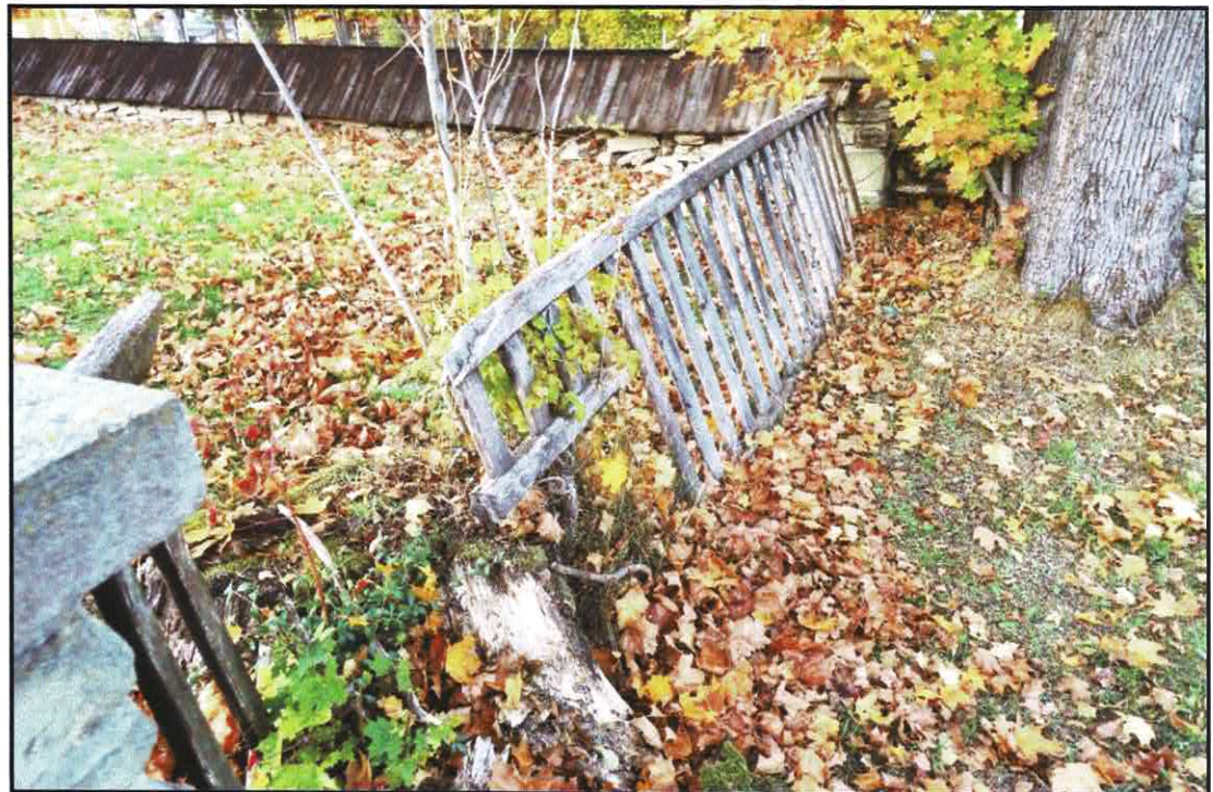
FOT. 26. CMENTARZ Z I WOJNY ŚWIATOWEJ NR 71 W ŁOSIU. Zniszczony odcinek drewnianego parkanu od str. zach., stan przed konserwacją. Październik 2022 r.
