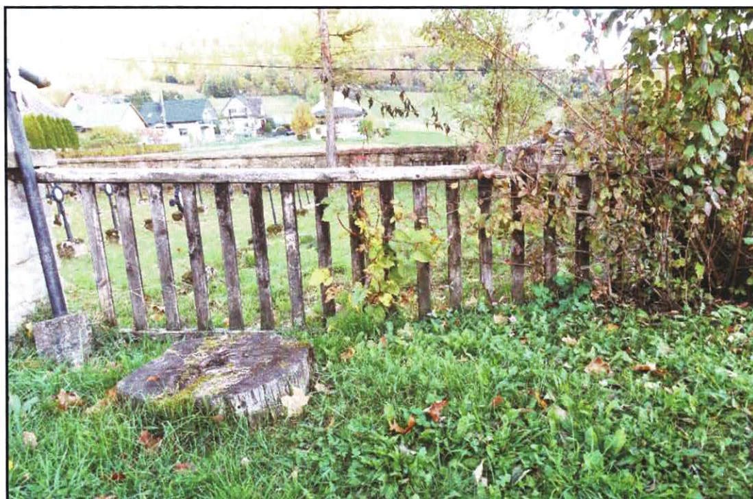
FOT. 22. CMENTARZ Z I WOJNY ŚWIATOWEJ NR 71 W ŁOSIU. Zniszczony odcinek drewnianego parkanu od str. zach., stan przed konserwacją. Październik 2022 r.
