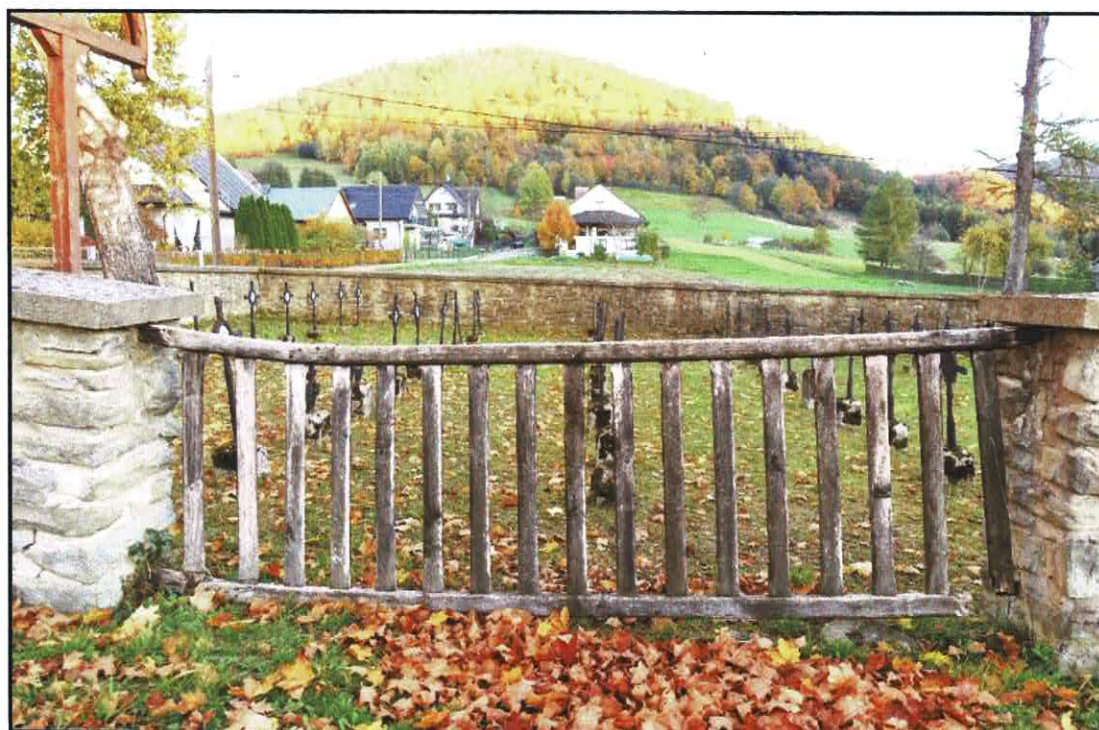
FOT. 24. CMENTARZ Z I WOJNY ŚWIATOWEJ NR 71 W ŁOSIU. Zniszczony odcinek drewnianego parkanu od str. zach., stan przed konserwacją. Październik 2022 r.
