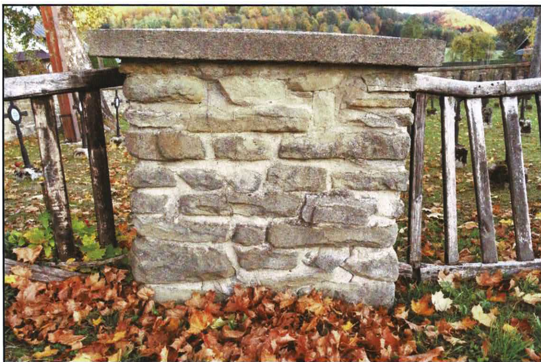
FOT. 17. CMENTARZ Z I WOJNY ŚWIATOWEJ NR 71 W ŁOSIU. Słup ogrodzenia z kamienia, stan przed konserwacją.
