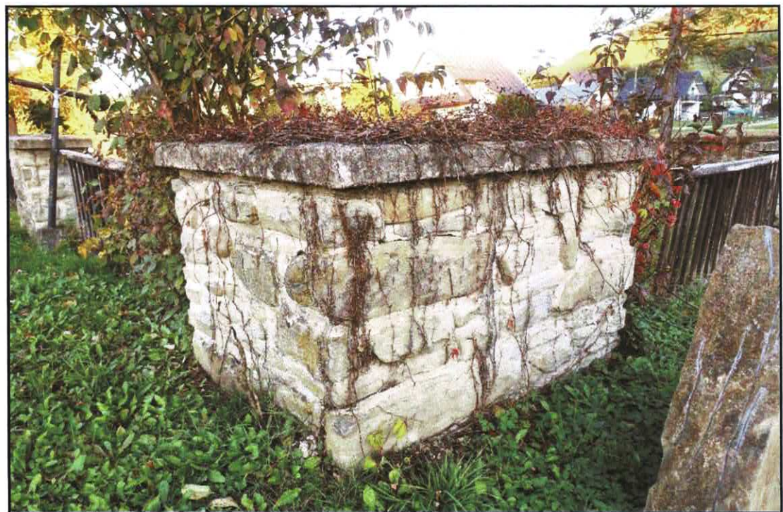
FOT. 14. CMENTARZ Z I WOJNY ŚWIATOWEJ NR 71 W ŁOSIU. Mur narożny od str. pld.- zach, stan przed konserwacją.
