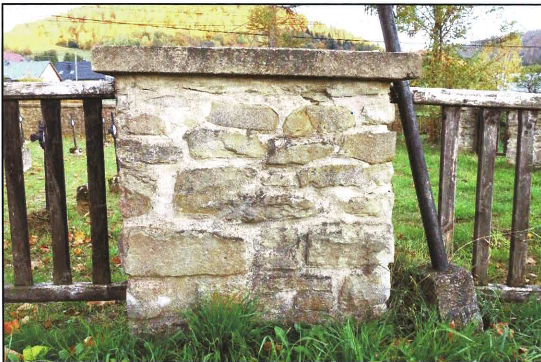
FOT. 15. CMENTARZ Z I WOJNY ŚWIATOWEJ NR 71 W ŁOSIU. Słup ogrodzenia z kamienia, stan przed konserwacją.
