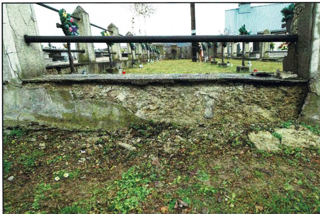
Fot. 51. CMENTARZ Z I WOJNY ŚWIATOWEJ NR 72 W ROPIE Fragment zniszczonego murku ogrodzenia, stan przed konserwacją. marzec 2024 r.
