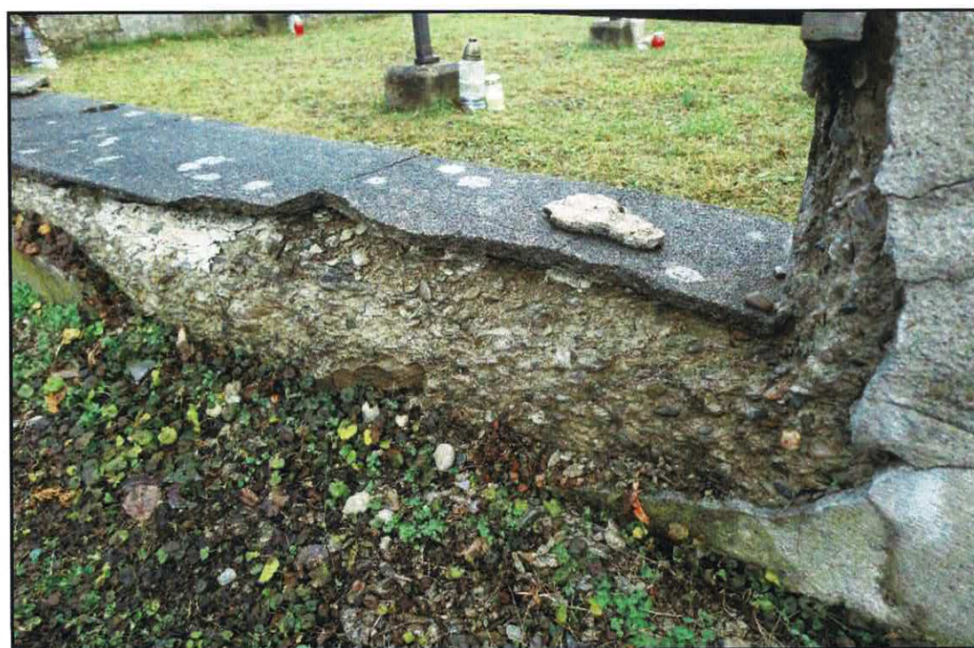
Fot. 52. CMENTARZ Z I WOJNY ŚWIATOWEJ NR 72 W ROPIE Fragment zniszczonego murku ogrodzenia, stan przed konserwacją. marzec 2024 r.
